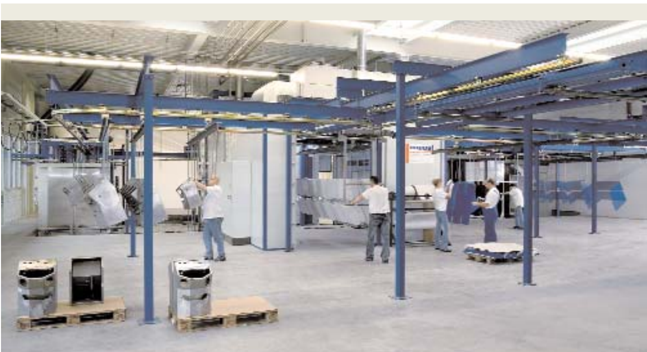
▲ Die Teile werden chargenweise durch die Anlage geführt und können aufgrund der speziellen Vorbehandlungs- und Fördertechnik sehr schnell und produktbezogen bearbeitet werden
